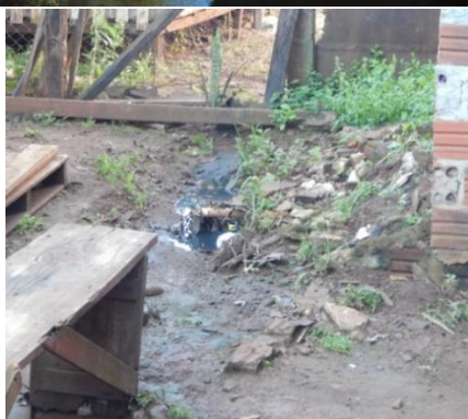
Lançamento do esgoto direto no solo
