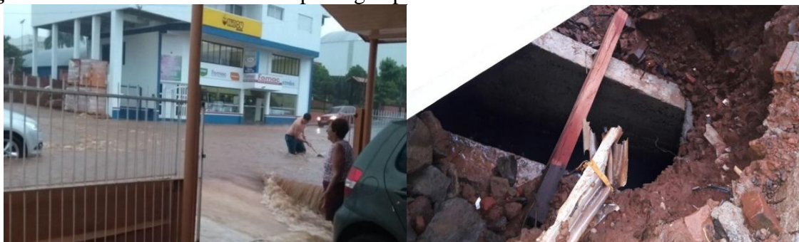
Figura 82: Problemas ocasionados pela água pluvial em 2018.
