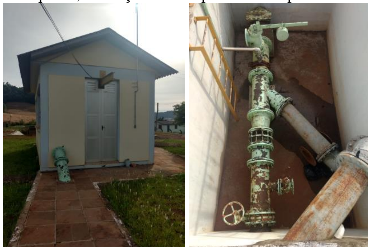
Figura 22: Casa de máquinas, tubulação de transporte de A.B para ETA e sistema de alívio.
