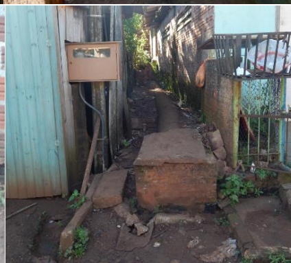
Galeria pluvial que vem do centro.
