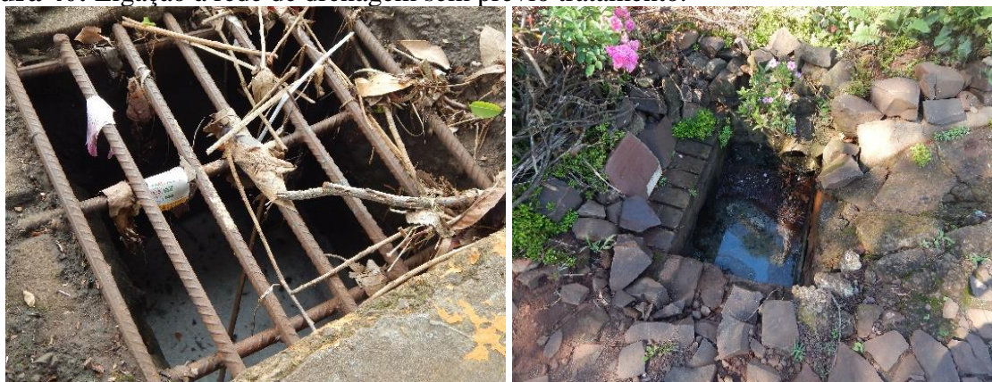
Figura 40: Ligação à rede de drenagem sem prévio tratamento.
