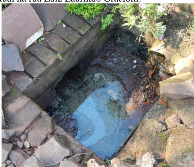
Caixa de captação pluvial destapada e com lançamento de óleo/graxa, na esquina da rua Delezio Dall Oglio.
