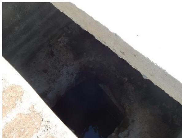
Boca de lobo com problema de refluxo, nota-se a presença de britas e barro.
