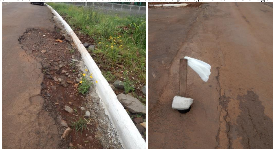
Figura 98: Problemas em vias devido a falta de estudo e planejamento na drenagem.
